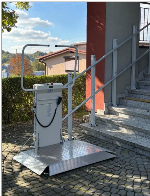
Markłowice ul. T. Zana 5 platforma schodowa
